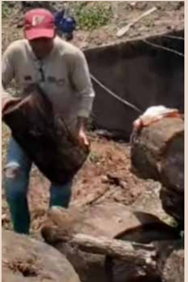
Alcaldía de Sucre y brigada de la esperanza atendieron situación de falla de borde en la T005
