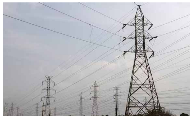
En materia eléctrica, el ministro de Energía Eléctrica, Rolando Alcalá, confirmó la restitución completa de la red de transmisión tras la emergencia. "Hemos recuperado el 100 % de las líneas de transmisión" (Foto LV)
