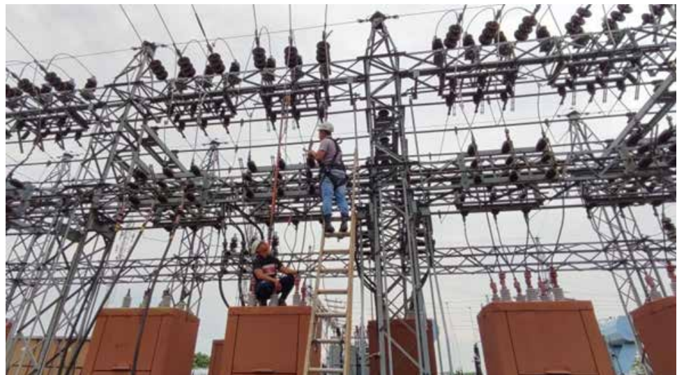
Fallas en la Subestación 3 de Barinas dejó sin luz a sectores de la RIM
