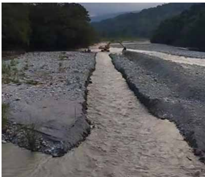
También hubo el despeje de vía en el sector El Celoso, por derrumbes debido a las fuertes lluvias.
