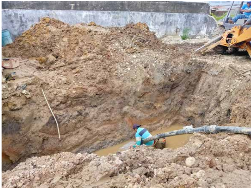
Arduo trabajo realiza personal de Hidroven para arreglar la ruptura de la tubería ( foto Neptali Querales)
