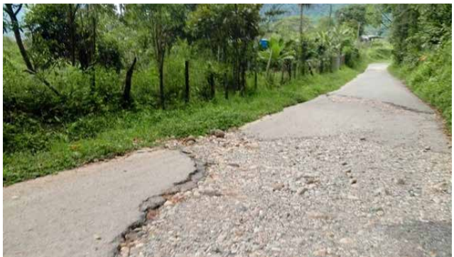
En franco deterioro vialidad en Calderas. ( foto Neptali Querales)
