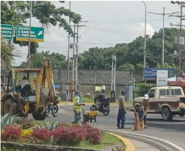
Mantenimiento vial en la redoma.
