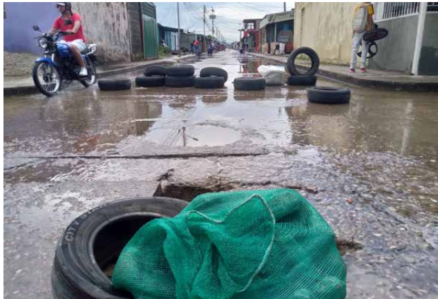
Colapsa vía por bote de aguas negras( foto Neptali Querales)
