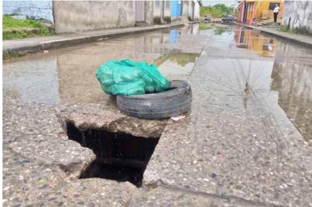
Vecinos trancan vía para evitar mayor deterioro ( foto Neptali Querales)
