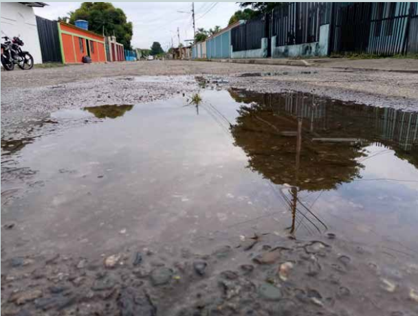
Bote de agua deteriora asfalto en la Francisco de Miranda ( foto Neptali Querales
