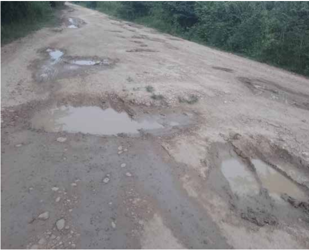
En deterioro vía entre Puerto de Nutrias y Guamito.
