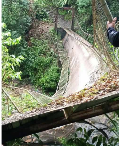
En estas gráficas se observa el estado de peligrosidad en que se encuentra el puente.
