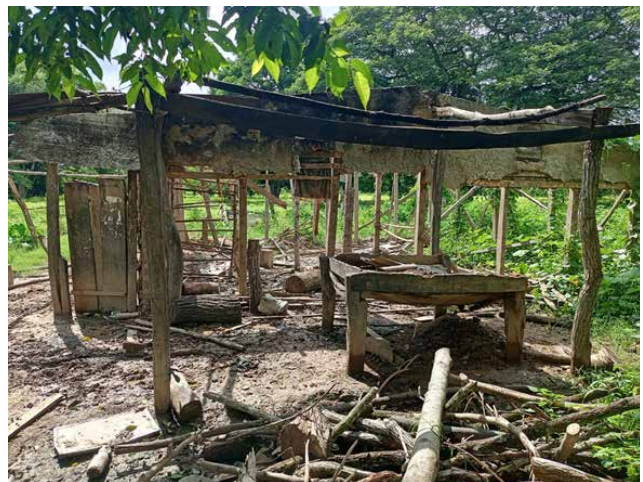
Destruyeron la vivienda sin compasión y sin importarle que es una persona de la tercera edad.
