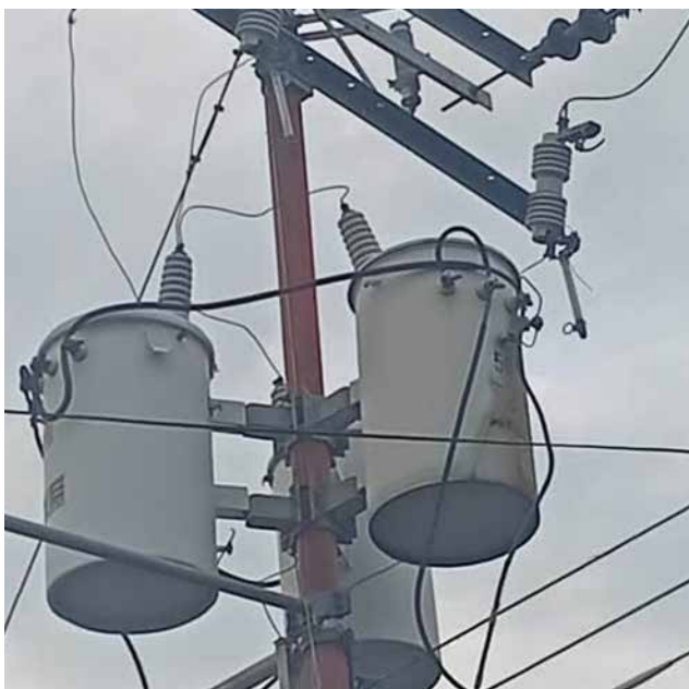
Dos transformadores piden en la Francisco de Miranda ( foto Neptali Querales)
