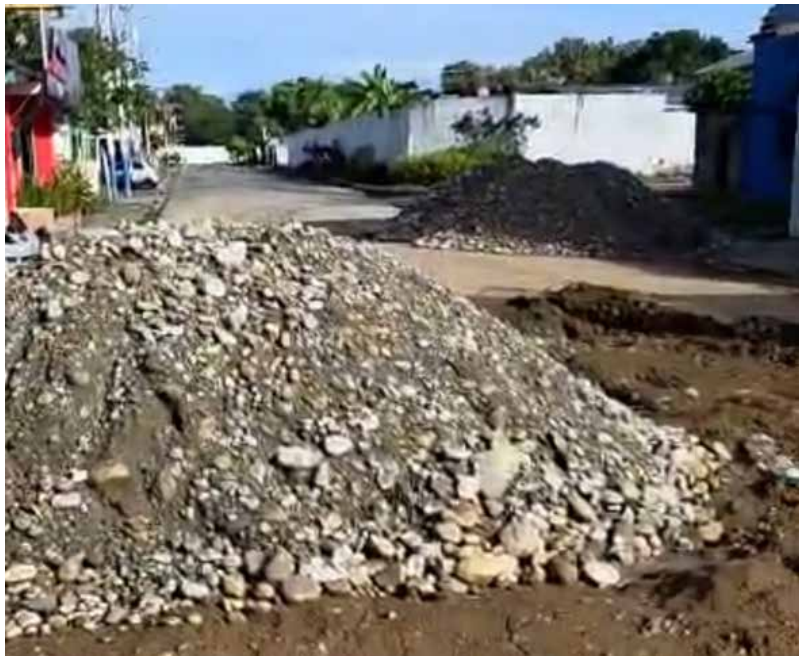
Las autoridades colocaron una carga de granzón que no soluciona el problema estructural.
