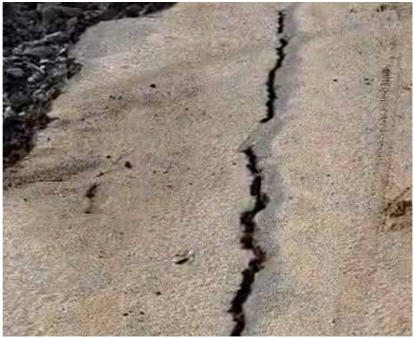
En las gráficas se presenta la situación que viven los vecinos de la calle Aranjuez , zanja el hundimiento del pavimento.
