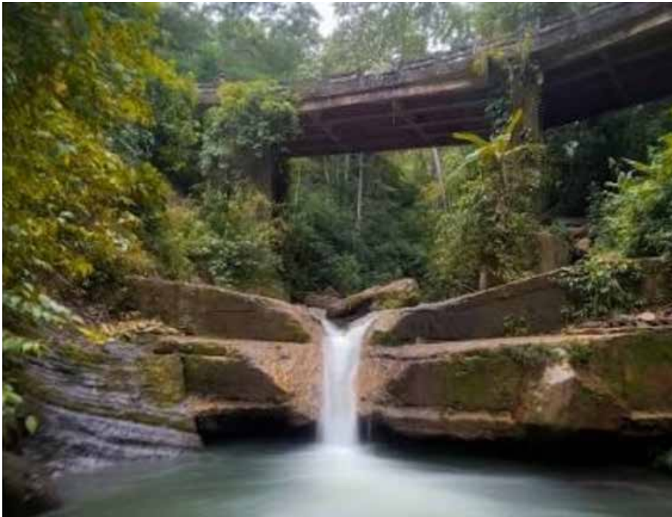
En deplorables condiciones y a punto del colapso puente del pozo El Rincón, en Altamira de Cáceres del municipio Bolívar
