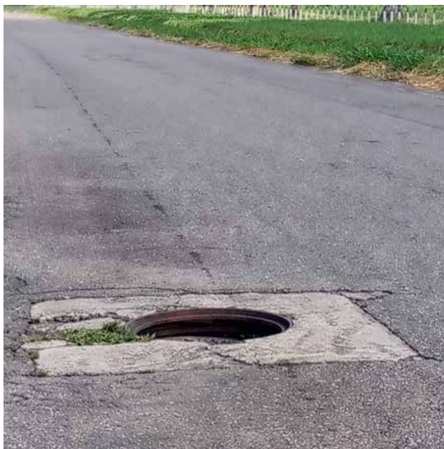
Falta de tapa de boca de visita se observa en la Nueva Torunos ( foto Neptali Querales)
