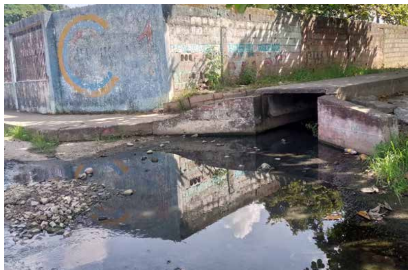
Cloacas rebosadas en Punta Gorda (foto Neptali Querales)
