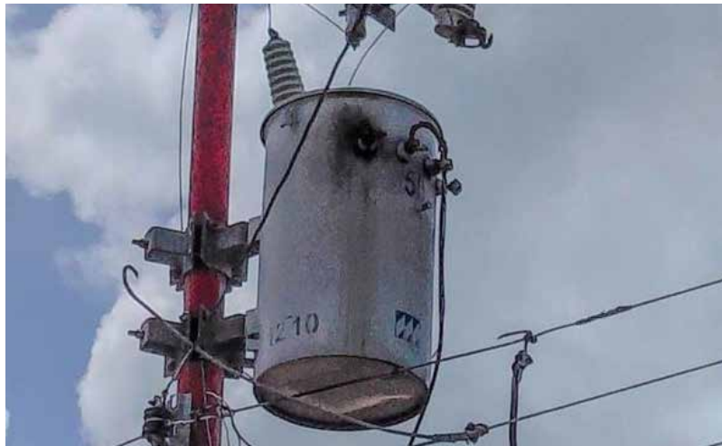
Se quemó transformador en Sabaneta
