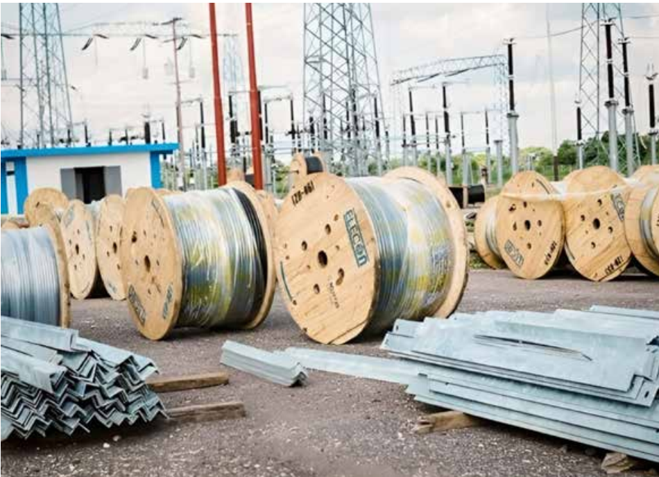
Autoridades anunciaron que la subestación comenzará a operar en pocos días, beneficiando a Portuguesa, Barinas, Mérida, Trujillo y el Alto Apure. (Foto VF)
