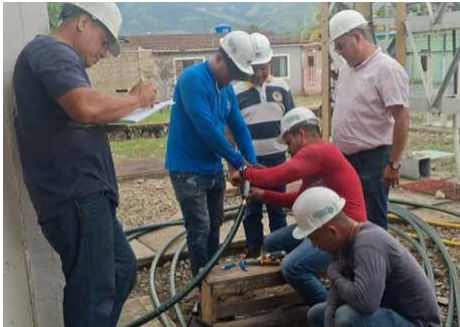
Entregado cable potencia para ser instalado en la Subestación Eléctrica de Socopó por medio del Ministerio de Energía y gobernación
