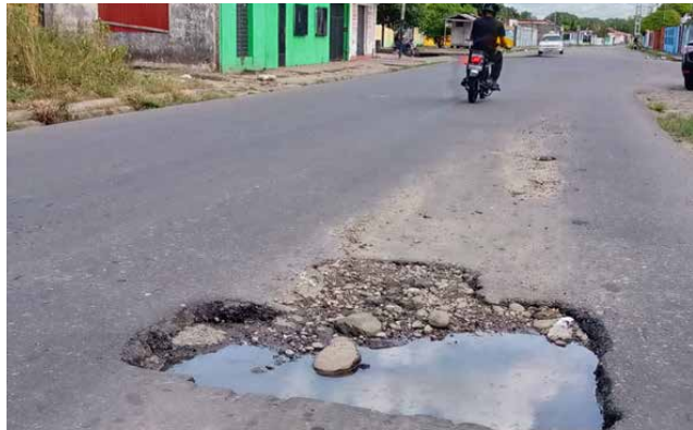
Enorme hueco en principal de Mijaguas (foto Neptalí Querales)
