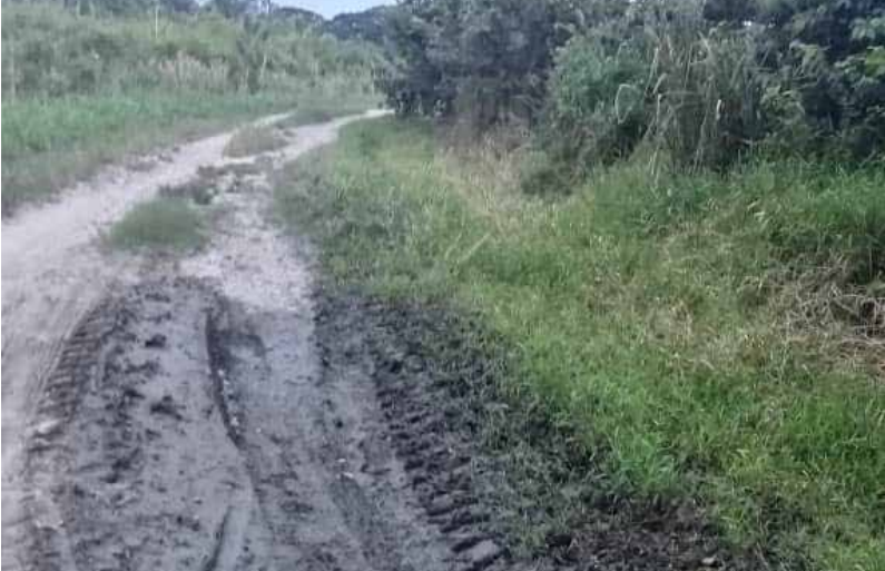
Vialidad en pésimas condiciones en El Real ( foto Neptali Querales)
