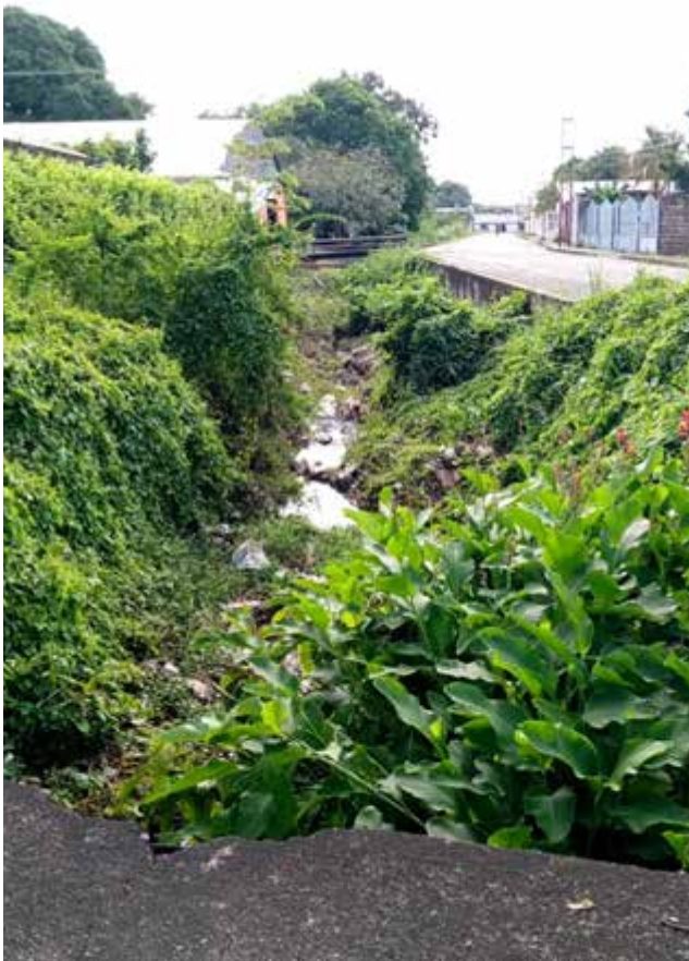
Limpieza piden para el canal del caño el Bobo ( foto Neptali Querales)
