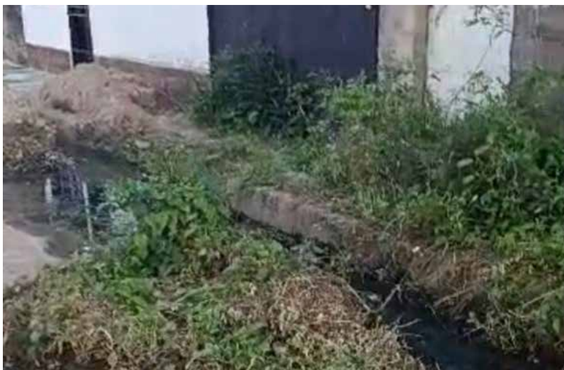
Las aguas servidas corren por calles del sector El Bajón en la Urb. Negro Primero
